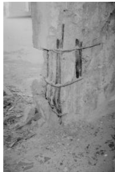
d/ Ruine par effort tranchant (Détail)
